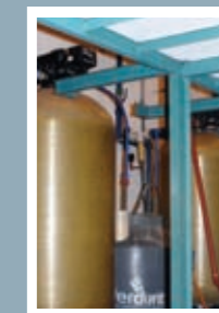
Planta de Agua
